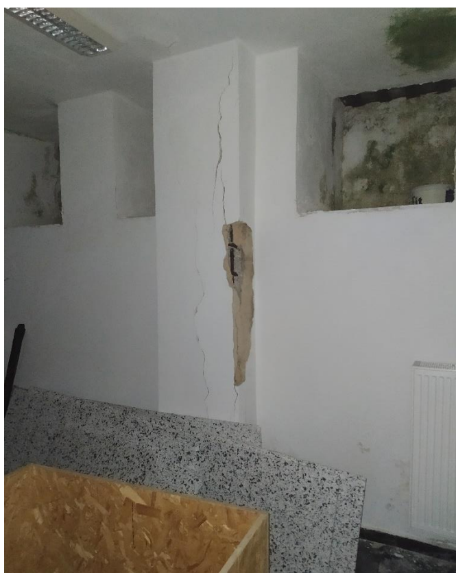
15. Άποψη Υπογείου - Φθορές στα στοιχεία σκυροδέματος λόγω οξείδωσης οπλισμού
