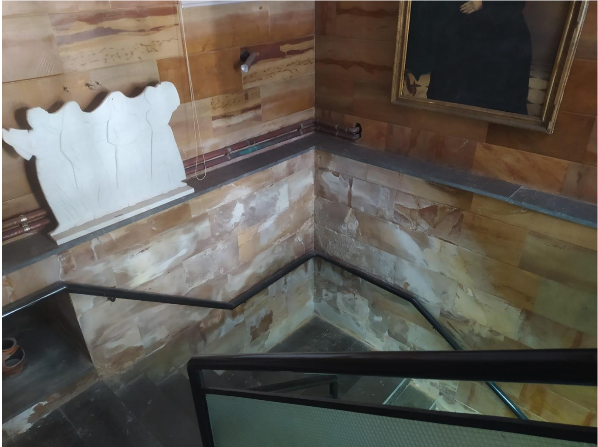
9. Άποψη ορόφου – Υγρασία στο κλιμακοστάσιο
