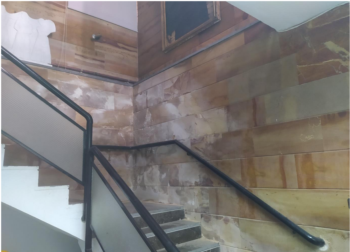
10. Άποψη υπογείου – Υγρασία στο κλιμακοστάσιο
