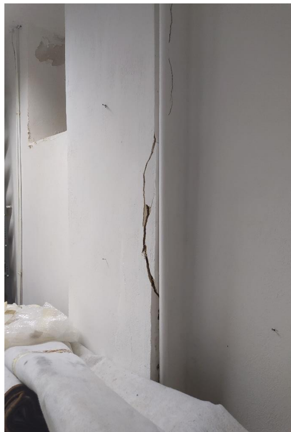
14. Άποψη Υπογείου - Φθορές στα στοιχεία σκυροδέματος λόγω οξείδωσης
