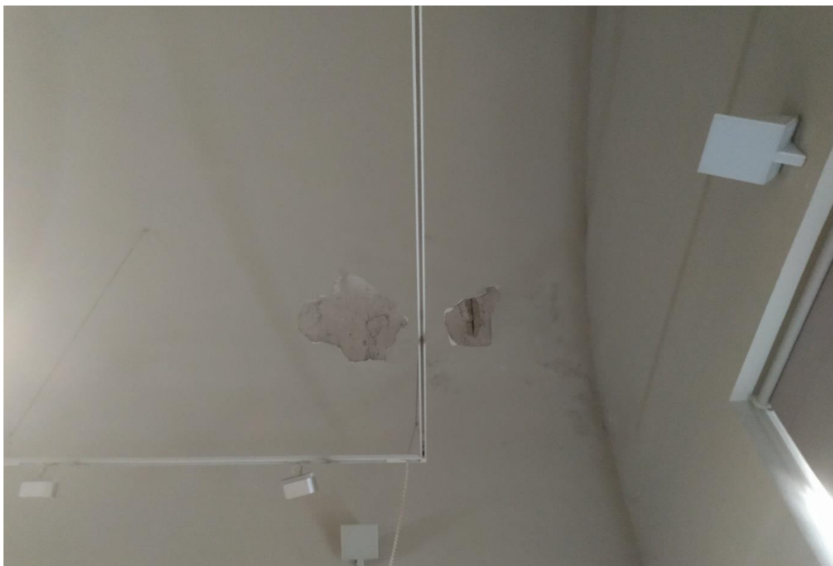
2. Άποψη ισογείου Λεπτομέρεια θολωτής οροφής από σκυρόδεμα – Καταπτώσεις επιχρισμάτων λόγω οξειδωσης οπλισμού
